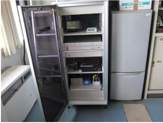
高洲 騒音測定器本体設置状況
