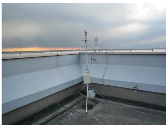
千鳥 航空機識別センサー設置状況
