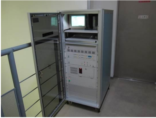
当代島 騒音測定器本体設置状況
